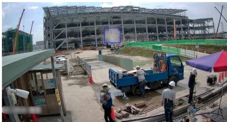
透過AI系統辨識工地揚塵後，立即通報業者改善。(南市環保局提供)
