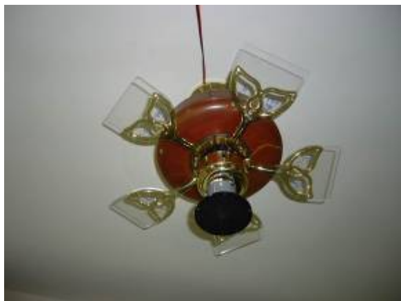
圖 68 吊扇電源另外拉出
