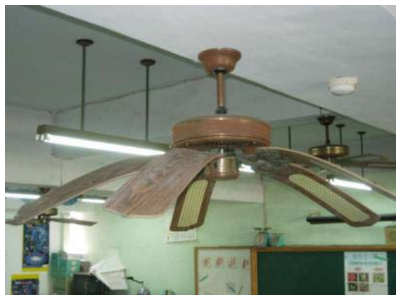
圖 5 吊扇扇葉變形
